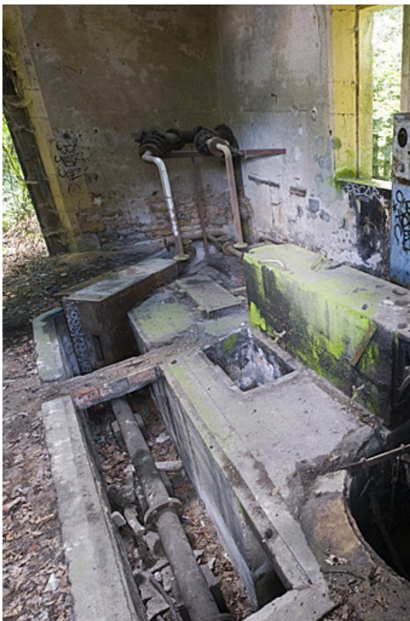
Station de pompage : détail de l'intérieur.
