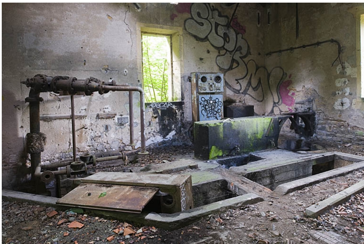
Station de pompage : Intérieur.
