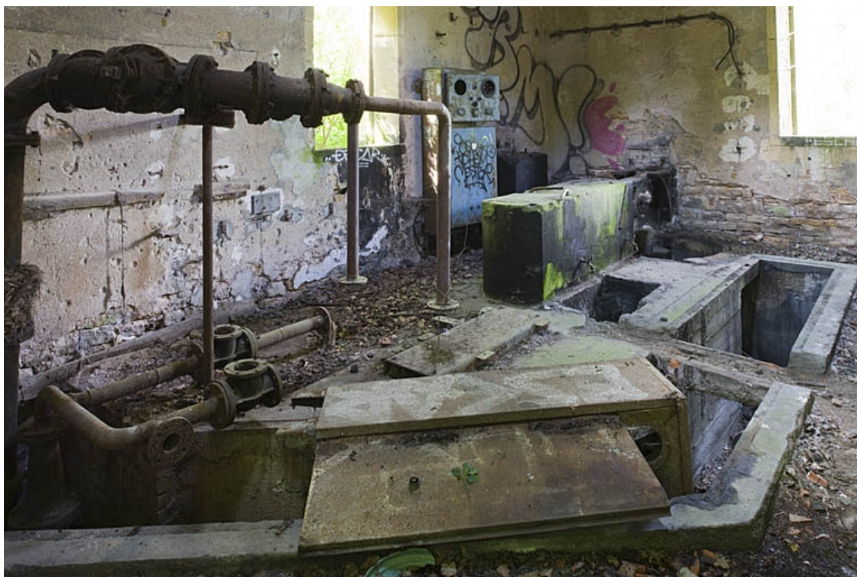
Station de pompage : vue rapprochée de l'intérieur.
