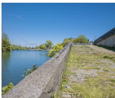
Rampe d'accès située juste en aval des quais à gradins. Phot. Thierry Kuntz IVR26_20172100256NUC4A
