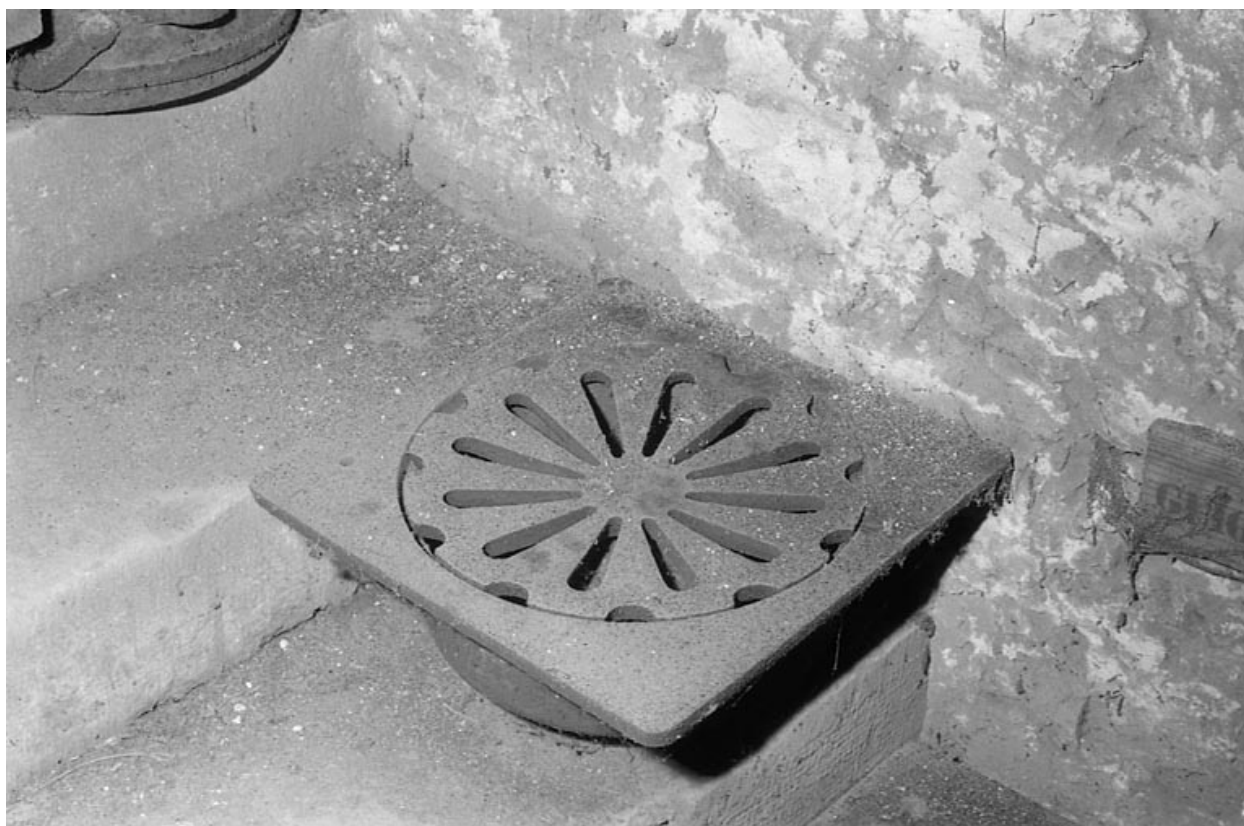
Regard d'eau pluviale.
