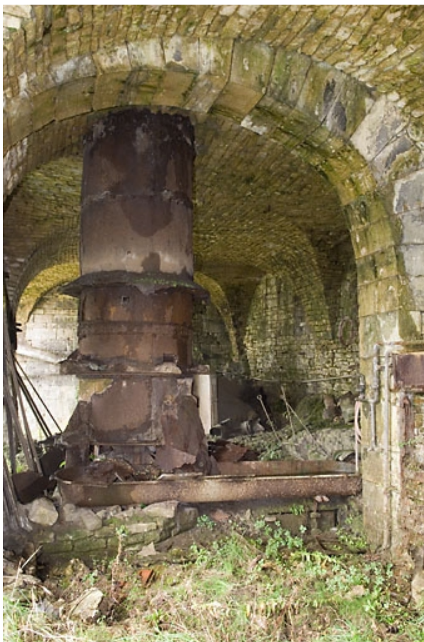
Cubilot ouest, dans son environnement.
