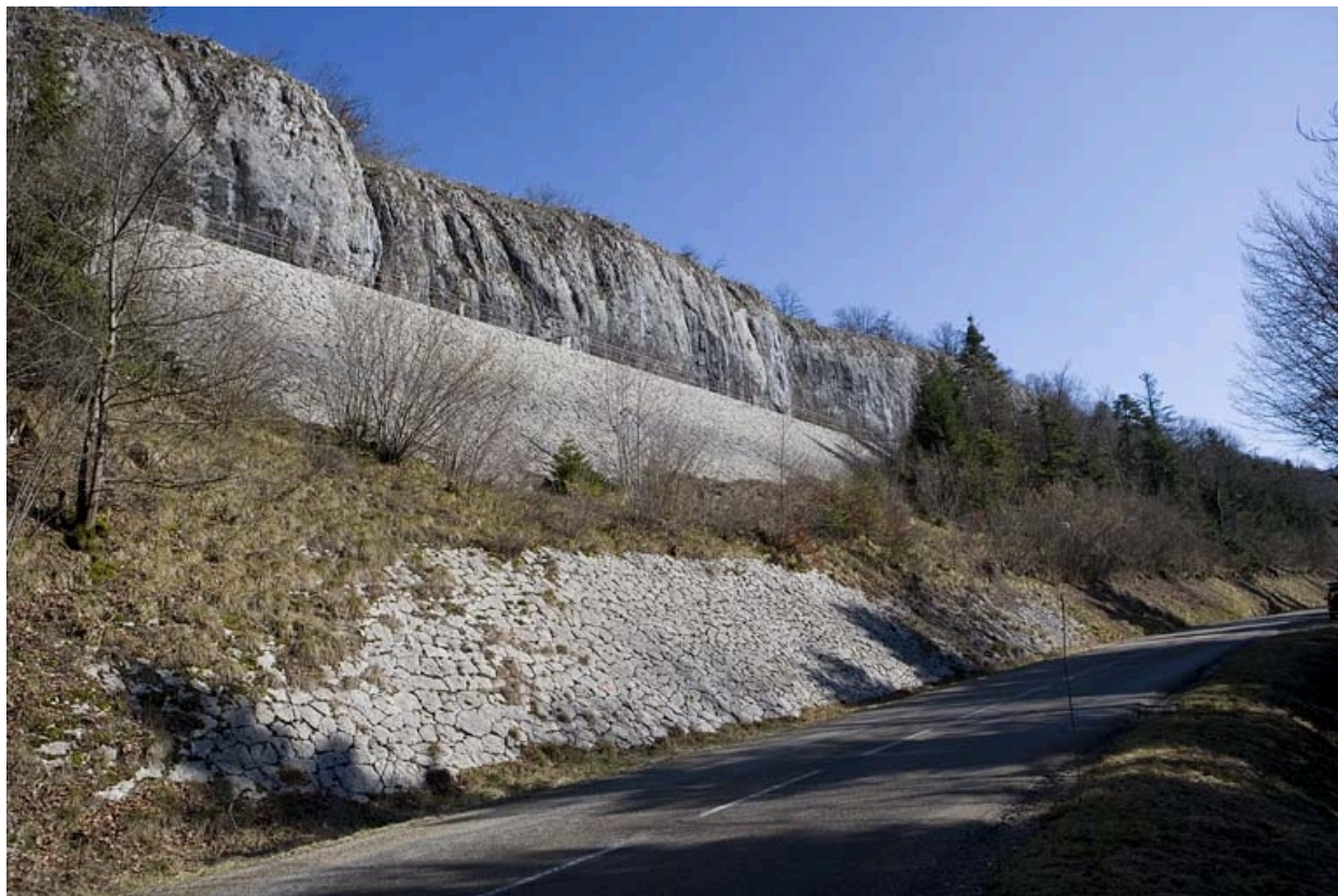
Murs de soutènement (commune de Champagnole), à droite de la voie avant le viaduc de Syam. Mur situé entre les PK 017.000 et 018.000, en contre-haut de la R.D. 127.
