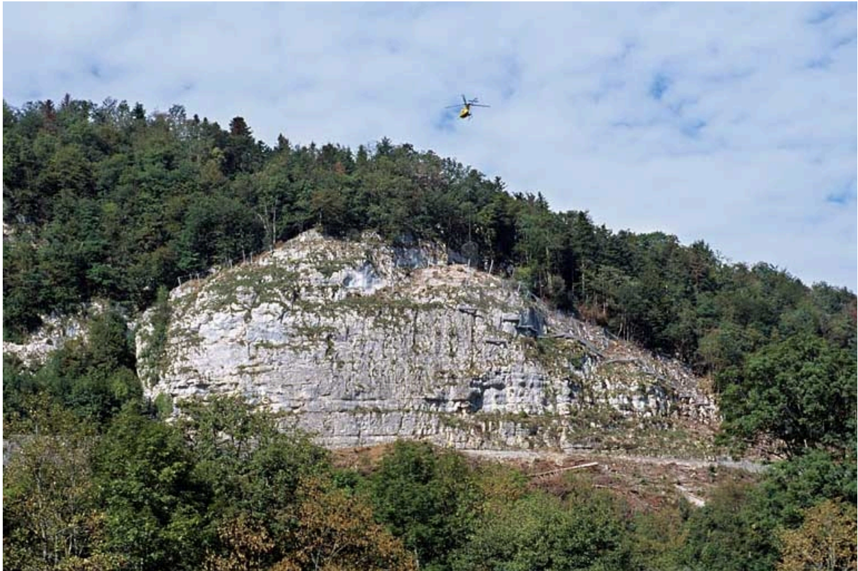
Sécurisation de paroi rocheuse à Syam : transport par hélicoptère d'un rouleau de filet de protection.
