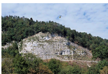
Sécurisation de paroi rocheuse à Syam : transport par hélicoptère d'un rouleau de filet de protection.
