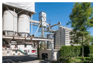
Silos et installations de chargement/déchargement. Phot. Jérôme Mongreville IVR43_20162501162NUC4A
