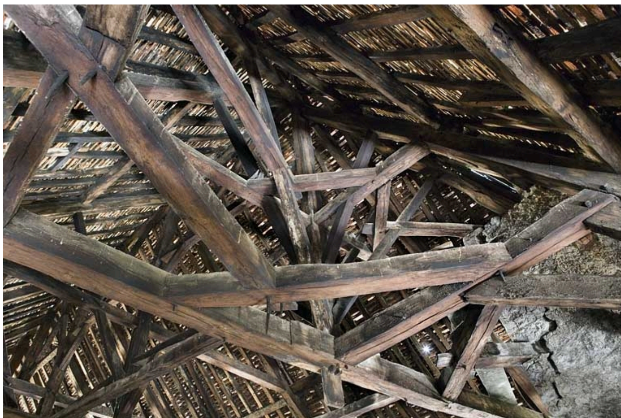
Intérieur, comble : détail des assemblages de la charpente à fermes et croix de Saint-André.
