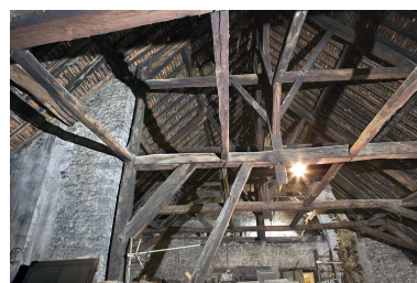
Intérieur, comble : vue d'ensemble de la charpente depuis le fond du grenier. Phot. Yves Sancey
