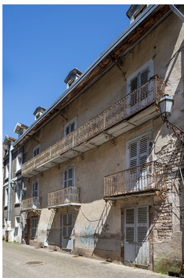
Façade sur l'allée des Romains, vue de trois quarts depuis le sud. Phot. Jérôme Mongreville IVR43_20207000560NUC4A
