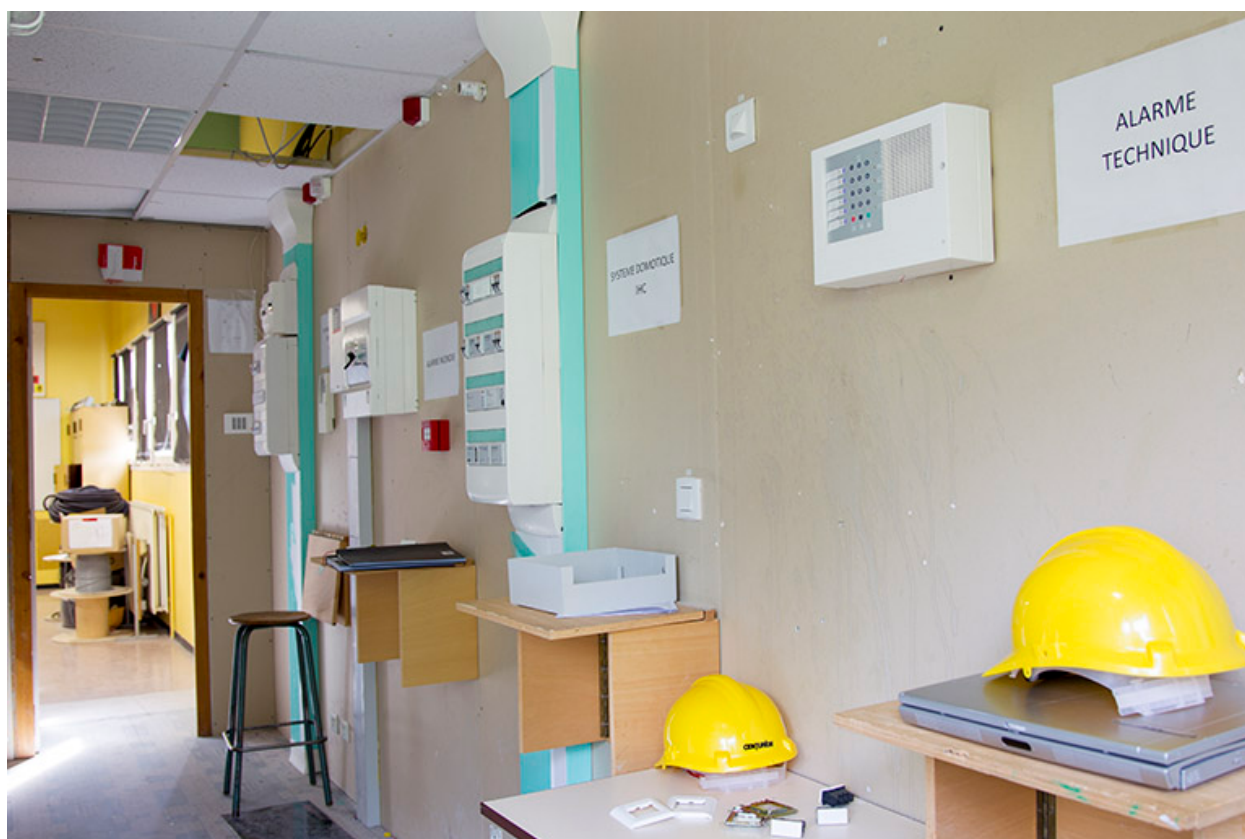
Intérieur de l'atelier des formations en électrotechnique.
