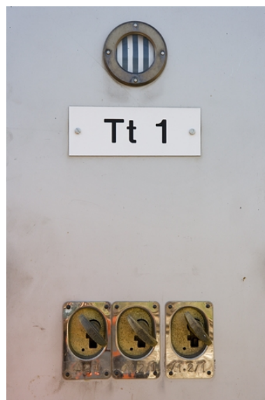
Terrain : transmetteur de gauche. Phot. Yves Sancey IVR43_20083900903NUC2A
