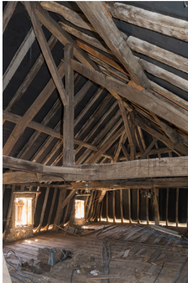
Vue de la charpente de toit brisé de la demeure Phot. Pierre-Marie Barbe-Richaud IVR26_20197100258NUC4A
