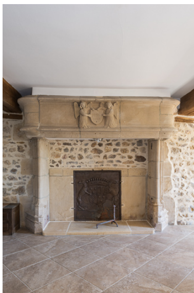
Cheminée de la salle principale de la demeure. Cette cheminée, caractéristique du XVe siècle, est un remploi et provient vraisemblablement de l'ancien château de l'Etoile. Phot. Pierre-Marie Barbe-Richaud IVR26_20197100269NUC4A
