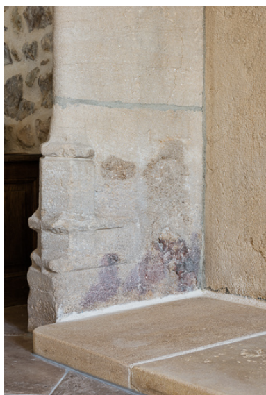
Détail de la cheminée : piédroit avec bases à moulures prismatiques Phot. Pierre-Marie Barbe-Richaud IVR26_20197100273NUC4A
