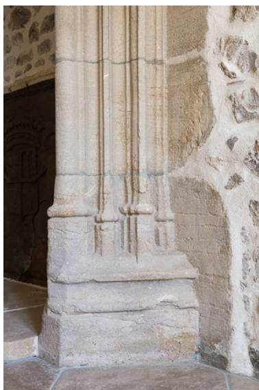
Détail de la cheminée : piédroit avec bases à moulures prismatiques Phot. Pierre-Marie Barbe-Richaud IVR26_20197100272NUC4A
