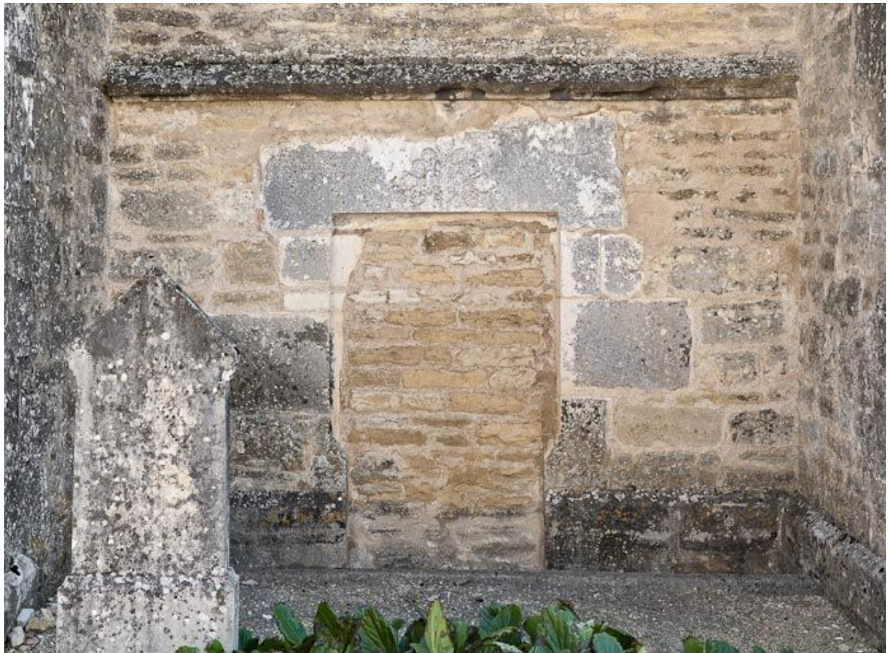
Porte latérale gauche murée.
