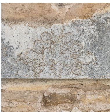
Linteau de la porte latérale gauche murée.
