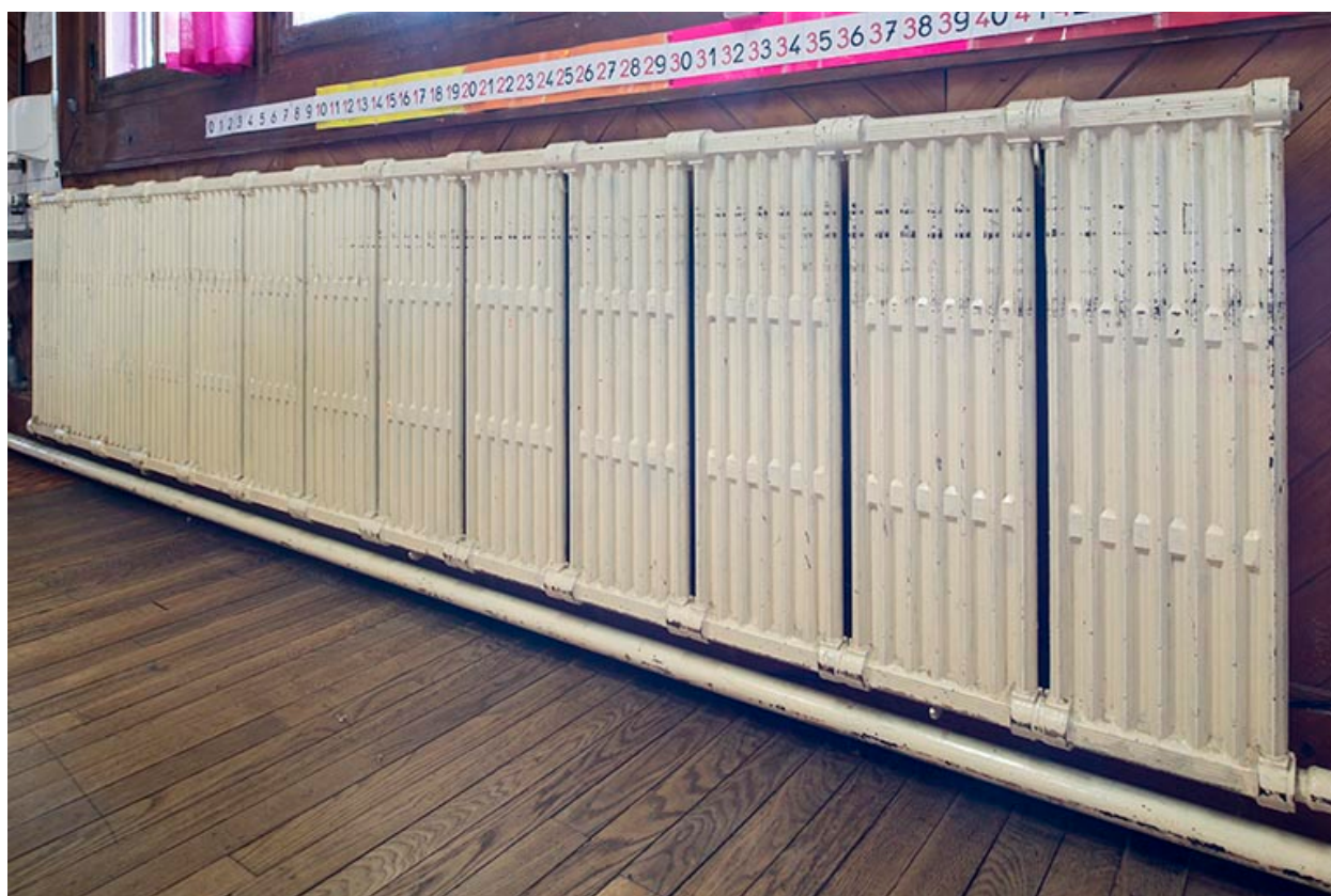
Les radiateurs d'une salle de classe.
