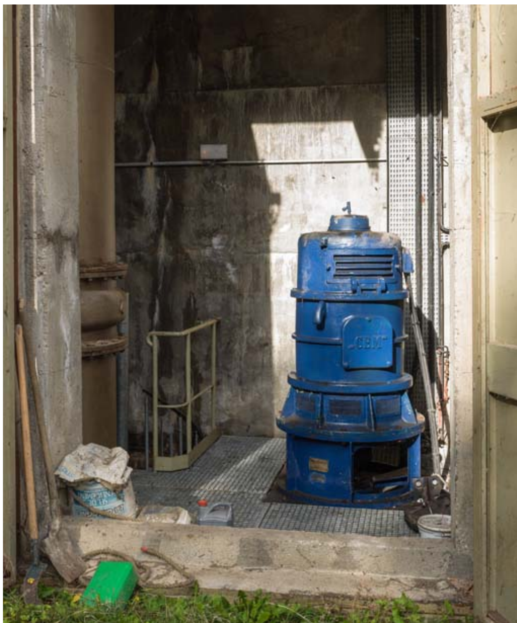
Détail de la station de pompage.
