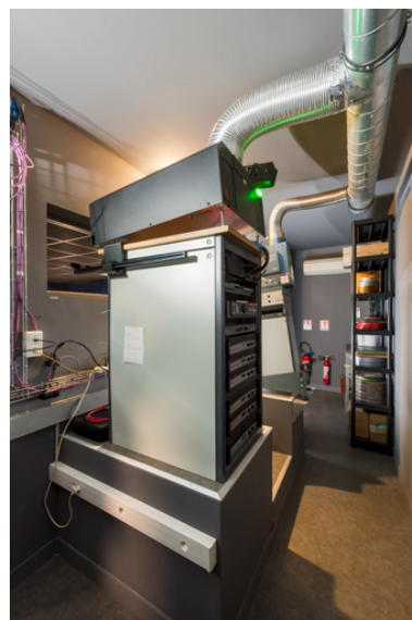
Cabine de la salle 4 : projecteurs numérique Barco (à gauche) et argentique 16 mm Hortson type G. Phot. Pierre-Marie Barbe-Richaud IVR26_20257100176NUC4A
