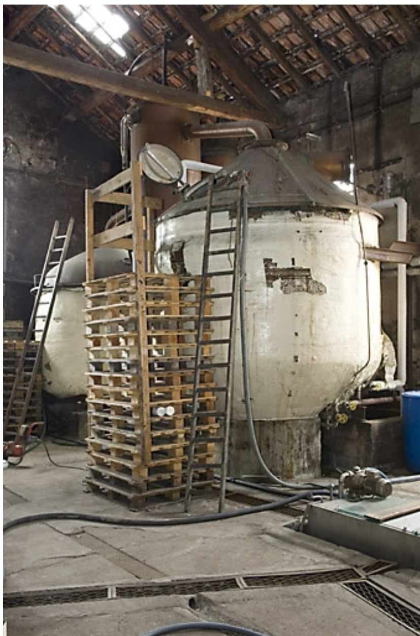
Ancien atelier de distillation. Alambics de 100 hl.
