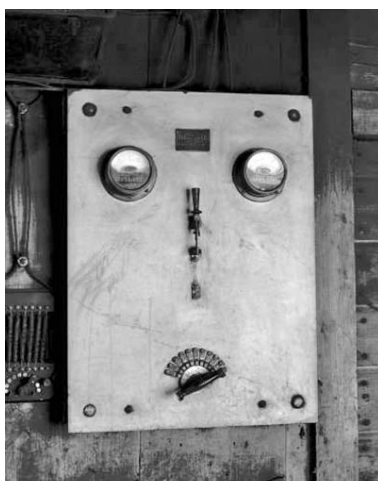
Intérieur : tableau de contrôle Grauer et Weil. Phot. Yves Sancey IVR43_19903900381X
