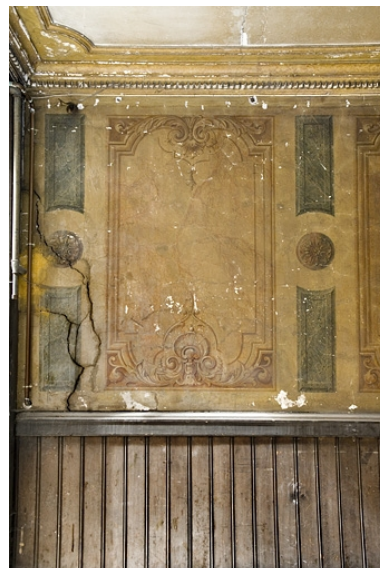
Peintures murales du passage cocher : détail du décor d'un panneau. Phot. Yves Sancey IVR43_20082500343NUC2A
