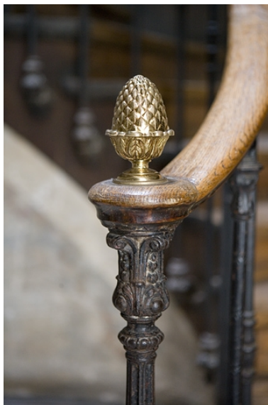
Détail du départ de la rampe d'appui de l'escalier principal. Phot. Yves Sancey IVR43_20082500340NUC2A
