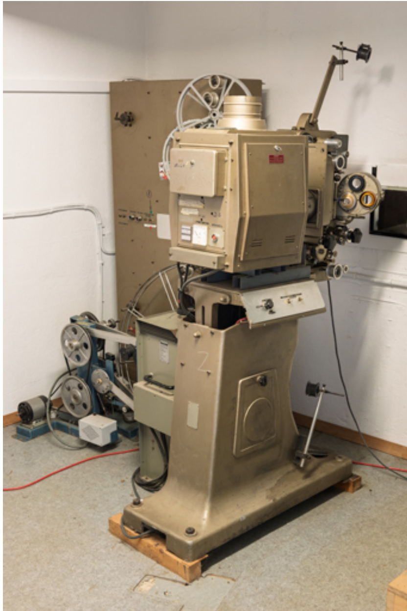
Cabine de projection : projecteur argentique Prevest.
