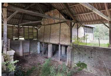
Aire de stockage des fagots de bois. Phot. Jérôme Mongreville IVR43_20152501888NUC4A
