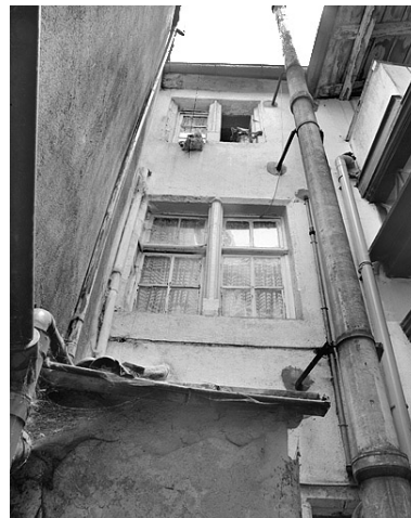
Façade sur cour du premier corps de bâtiment. Phot. Jérôme Mongreville IVR43_19872500960X
