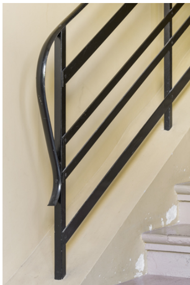
Aile nord : départ de rampe de l'escalier du personnel. Phot. Pierre-Marie Barbe-Richaud IVR26_20238901009NUC4A
