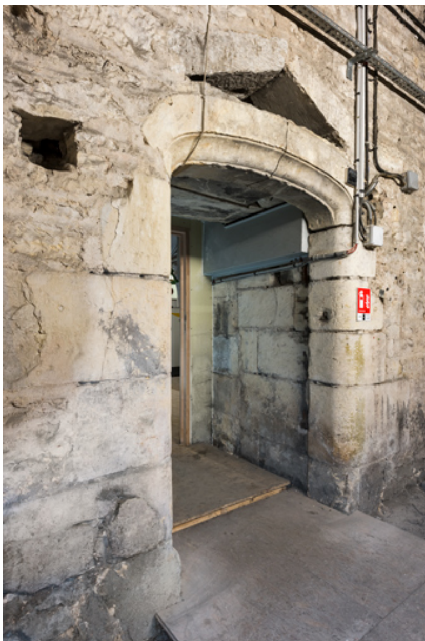
Etage de soubassement, partie droite : entrée de la chaufferie.
