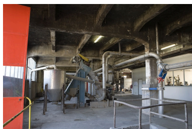
Atelier de trituration. Partie ouest (second étage).
