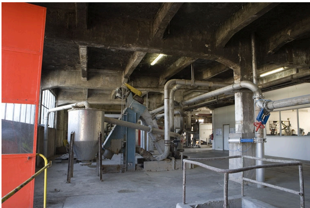
Atelier de trituration. Partie ouest (second étage).
