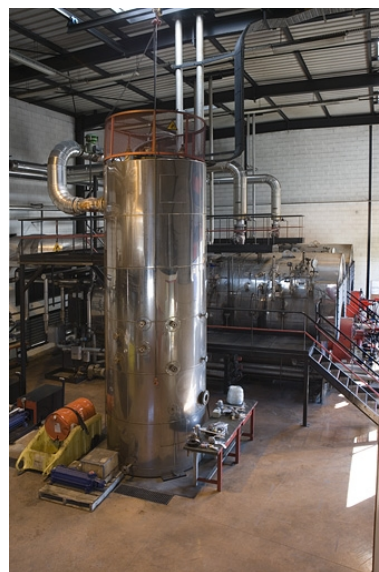
Chaudière. Vue intérieure.
