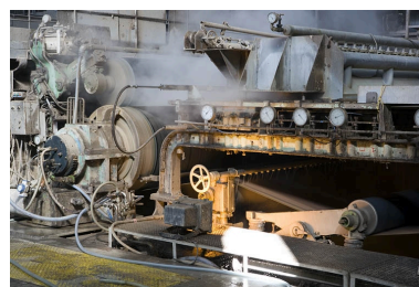
Machine à papier. Détail du mécanisme des cylindres.
