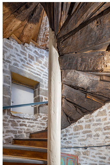
Escalier en vis (entrée n°1 cour des Halles). Détail des marches. Phot. Jérôme Mongreville IVR43_20233900093NUC4A
