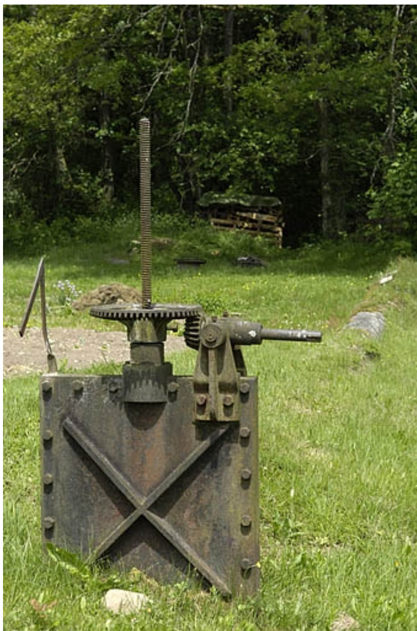
Vannage de la conduite forcée.
