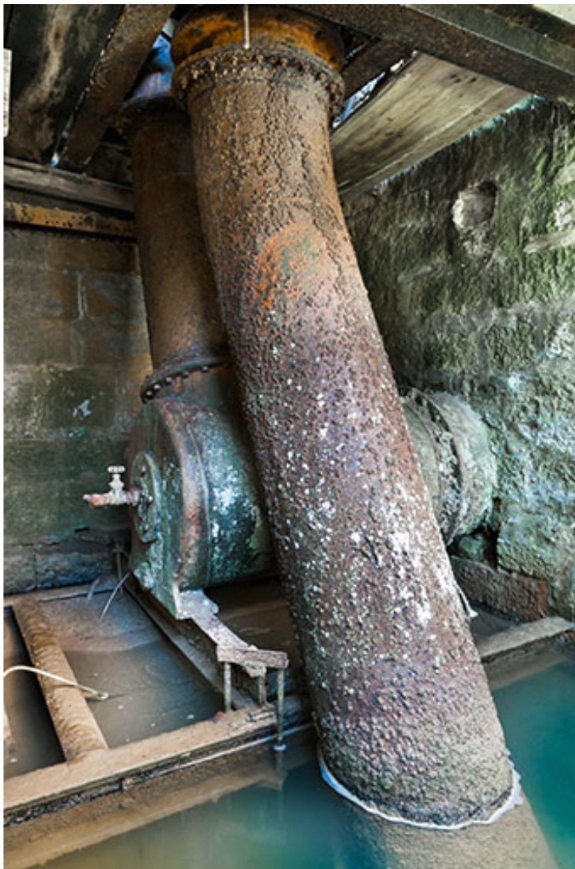
Turbine hydraulique (partie inférieure).
