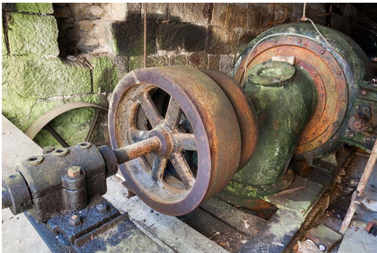
Turbine hydraulique (partie supérieure).
