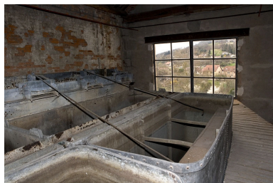
Atelier de préparation de la pâte. Cuves de stockage et de distribution de l'eau. Phot. Yves Sancey IVR43_20092500369NUC2A
