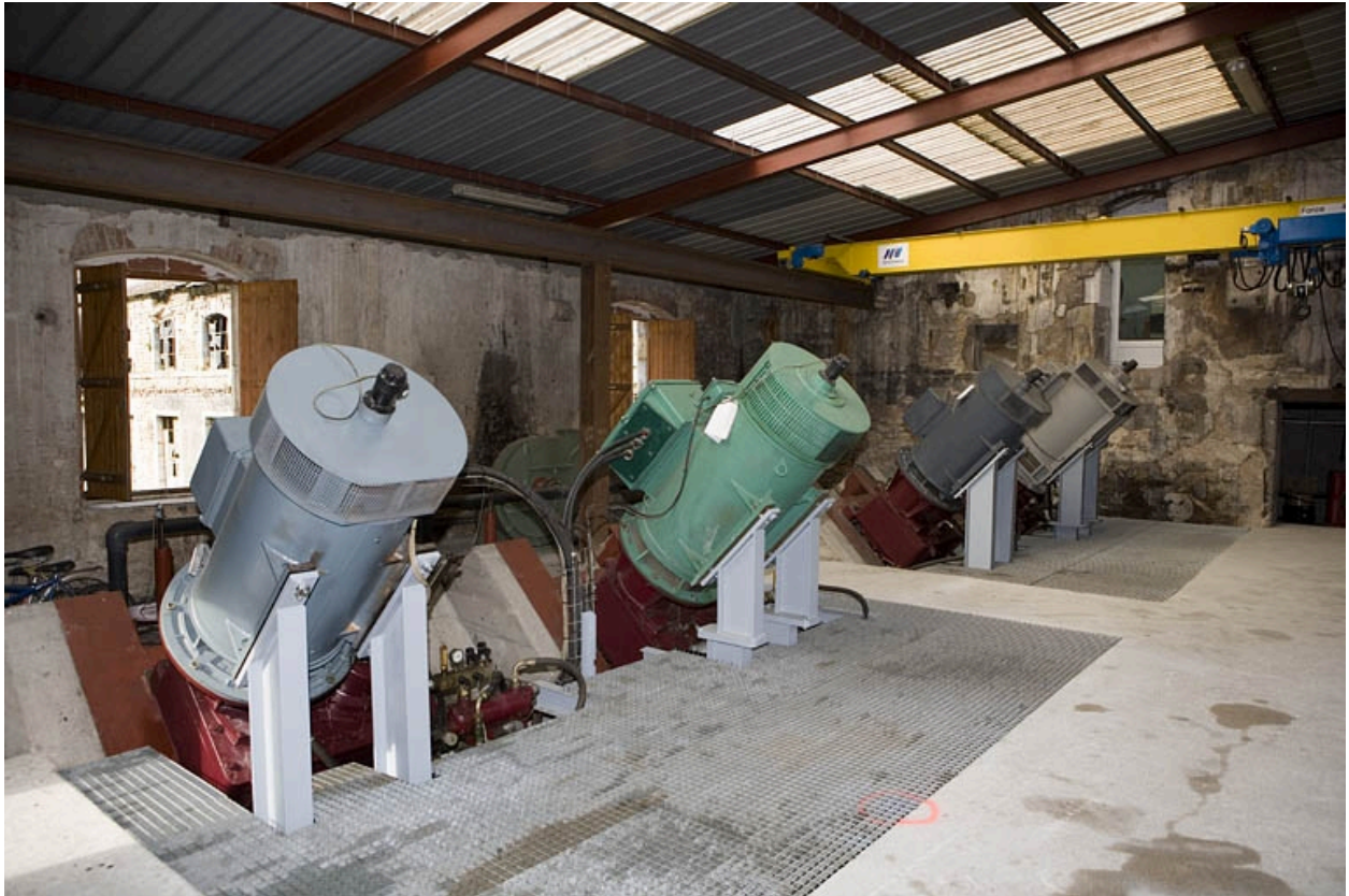
Bâtiment d'eau. Les turbines modernes.
