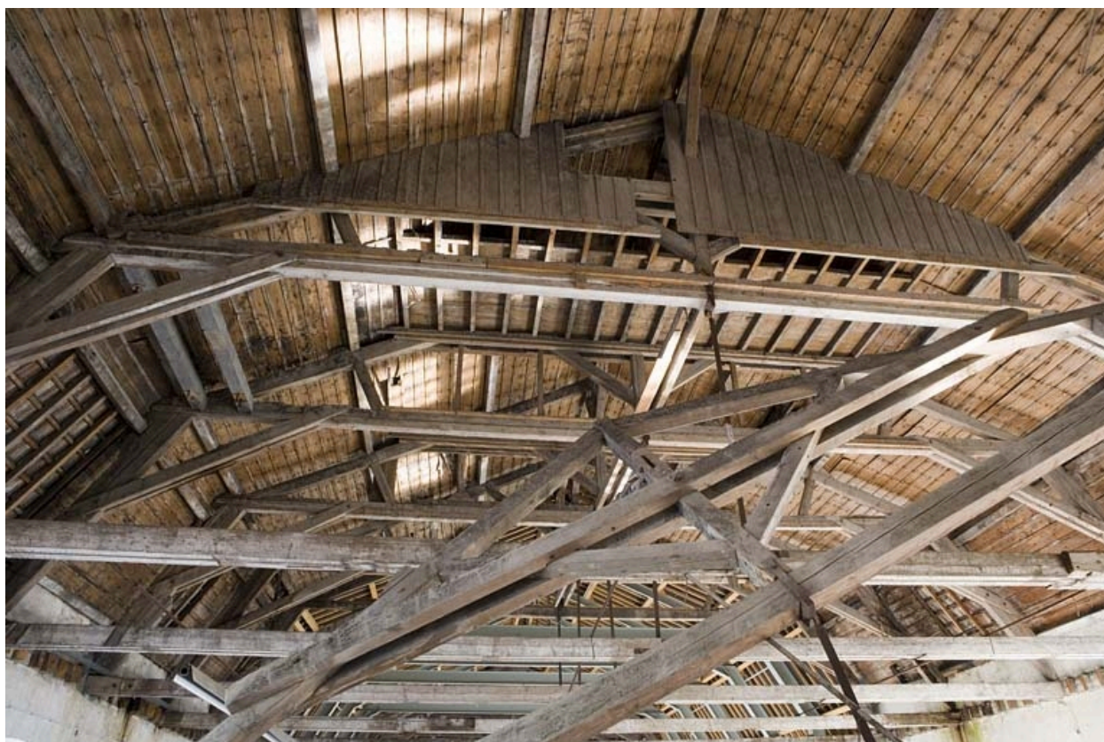
Atelier de préparation de la pâte. Eléments de la charpente (ferme effondrée au premier plan).
