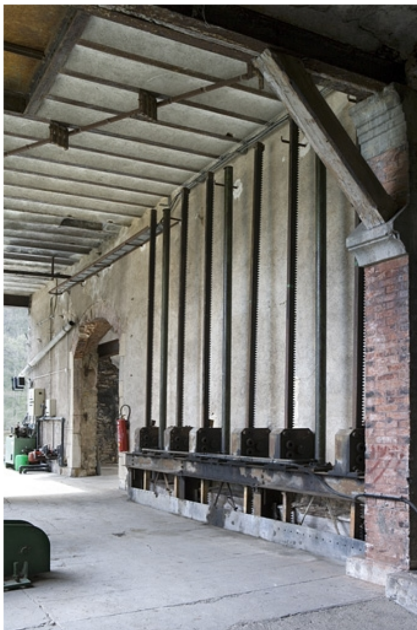
Bâtiment d'eau. Vue rapprochée du système Fontaine.
