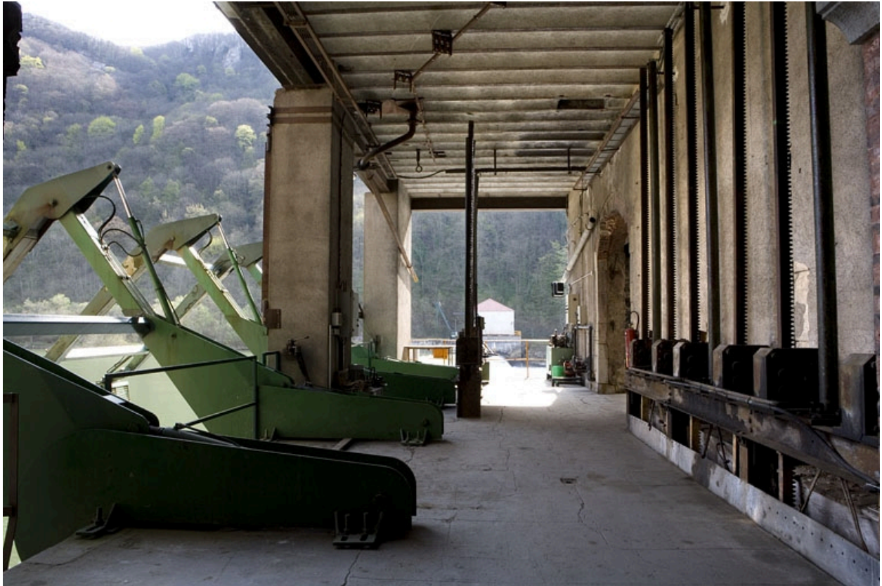
Bâtiment d'eau. Système d'admission et de régulation (système Fontaine) et dégrilleur.
