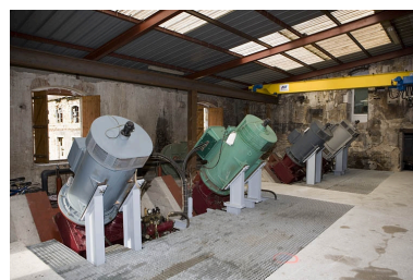
Bâtiment d'eau. Les turbines modernes. Phot. Yves Sancey IVR43_20092500351NUC2A
