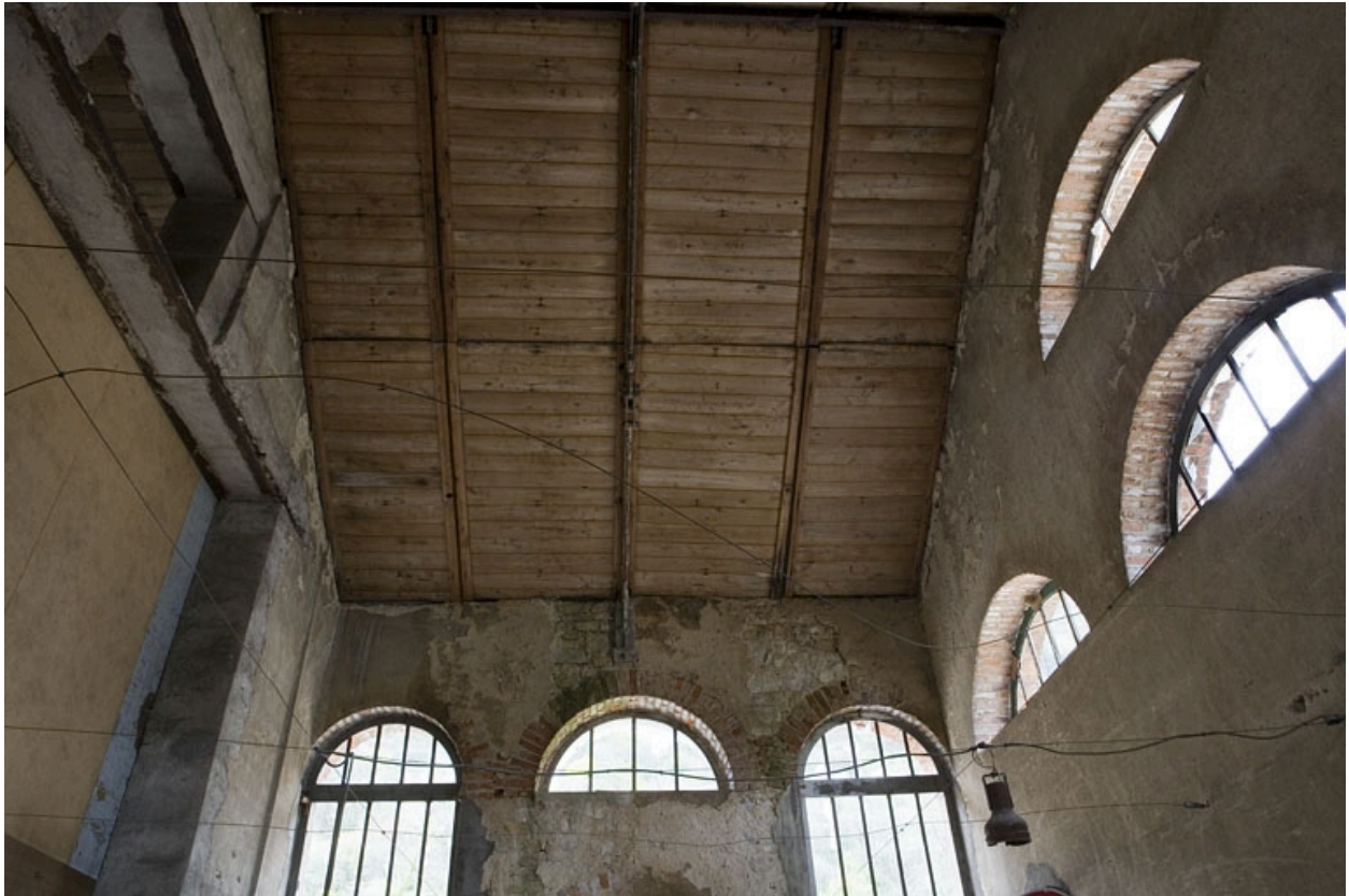
Atelier de réparation. Vue intérieure.
