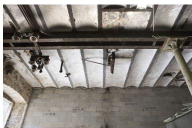
Bâtiment d'eau. Détail du plancher supérieur en entrevous en berceau segmentaire. Phot. Yves Sancey IVR43_20092500350NUC2A
