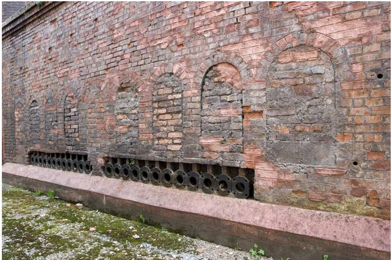
Orifices des tubes de la chaudière.
