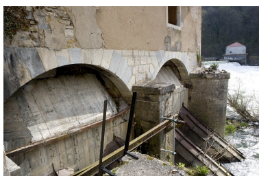
Bâtiment d'eau. Conduites d'évacuation d'eau. Phot. Yves Sancey IVR43_20092500349NUC2A
