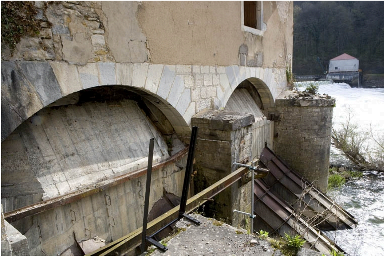
Bâtiment d'eau. Conduites d'évacuation d'eau.
