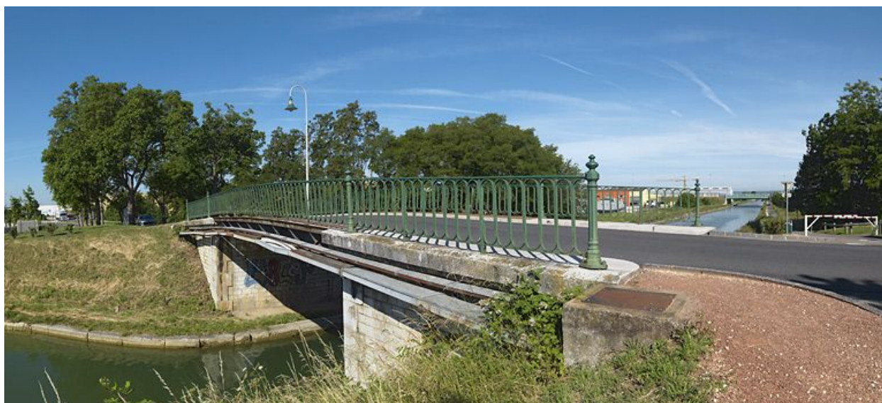
Vue rapprochée : le garde-corps ancien.
