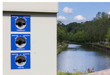
Commandes pour l'ouverture et la fermetures du vantail et des vannes. Phot. Sonia Dourlot IVR43_20157000920NUC2A
