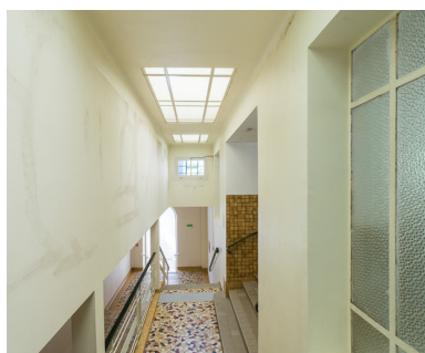
Passage du couloir (à gauche) dans l'établissement thermal. Phot. Pierre-Marie Barbe-Richaud IVR26_20195800199NUC4AQ
