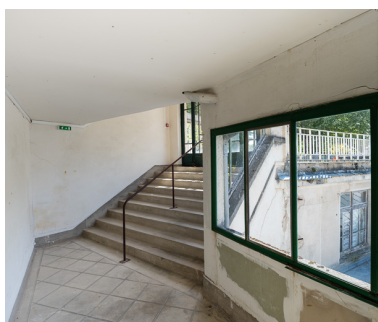
Vue intérieure en direction de la terrasse de l'hôtel. Phot. Pierre-Marie Barbe-Richaud IVR26_20195800198NUC4AQ
