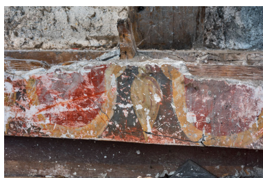
Comble de l'ancien théâtre : vestige du décor de la coupole. Phot. Pierre-Marie Barbe-Richaud IVR26_20238900217NUC4A
