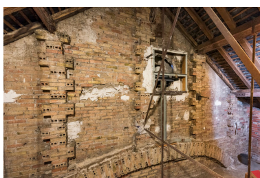
Combles : mur séparant la salle de l'ancien théâtre (vu depuis la salle). Phot. Pierre-Marie Barbe-Richaud IVR26_20238900214NUC4A
