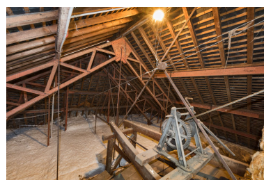
Comble de la salle : charpente métallique et treuil du lustre. Phot. Pierre-Marie Barbe-Richaud IVR26_20238900210NUC4A
