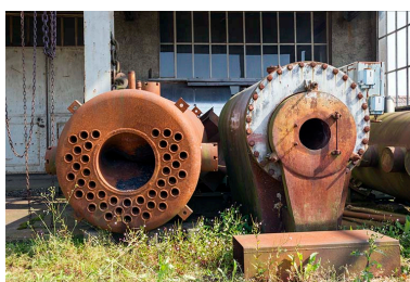
Site rue du Contremont : chaudières à vapeur. Phot. Yves Sancey IVR43_20132501442NUC2A
