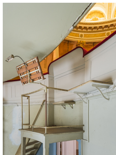
Sous-sol, salle du jeu d'orgue : estrade du chef d'orchestre (vue rapprochée). Phot. Pierre-Marie Barbe-Richaud IVR26_20257100346NUC4A
