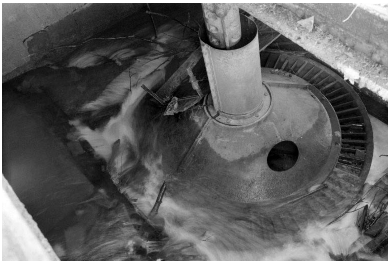
Forge Neuve. Bâtiment d'eau (L) : partie supérieure de la turbine.
