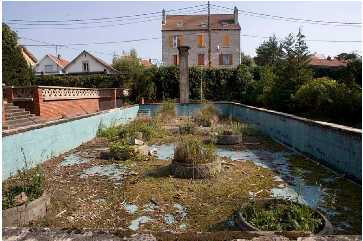
Piscine : le bassin à l'abandon.
