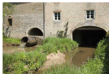
Canal de fuite. Phot. Jérôme Mongreville IVR43_20067000269NUCA
