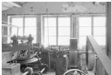
Transmission entre la turbine et la dynamo. Phot. Laurent Poupard IVR43_19903900504Z
