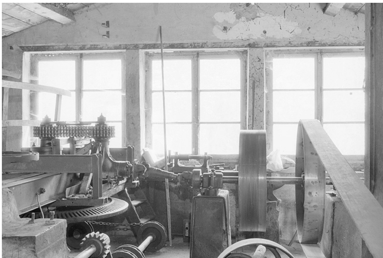
Transmission entre la turbine et la dynamo.
