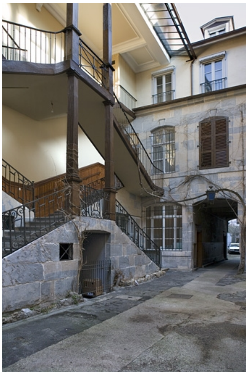
Détail de l'escalier à cage ouverte et de la façade antérieure du premier logis secondaire.
