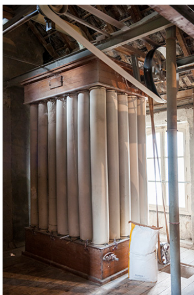
Troisième étage. Filtre à air. Phot. Jérôme Mongreville IVR43_20152501865NUC4A
