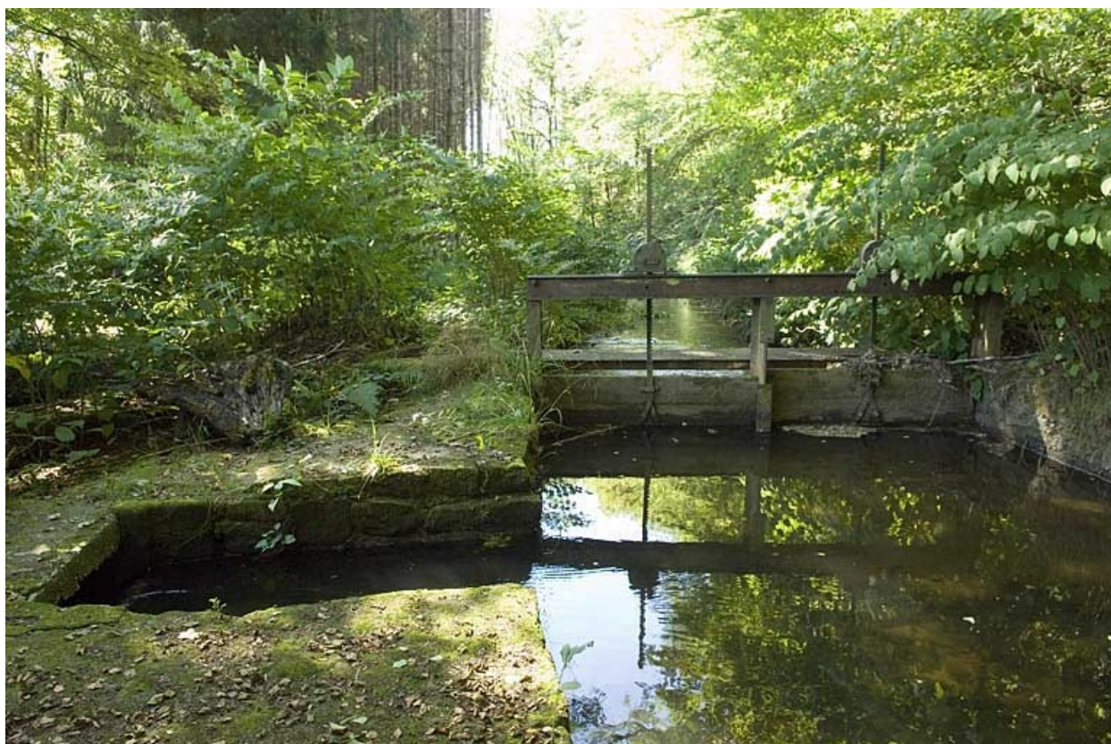
Vannage sur le bief de dérivation.
