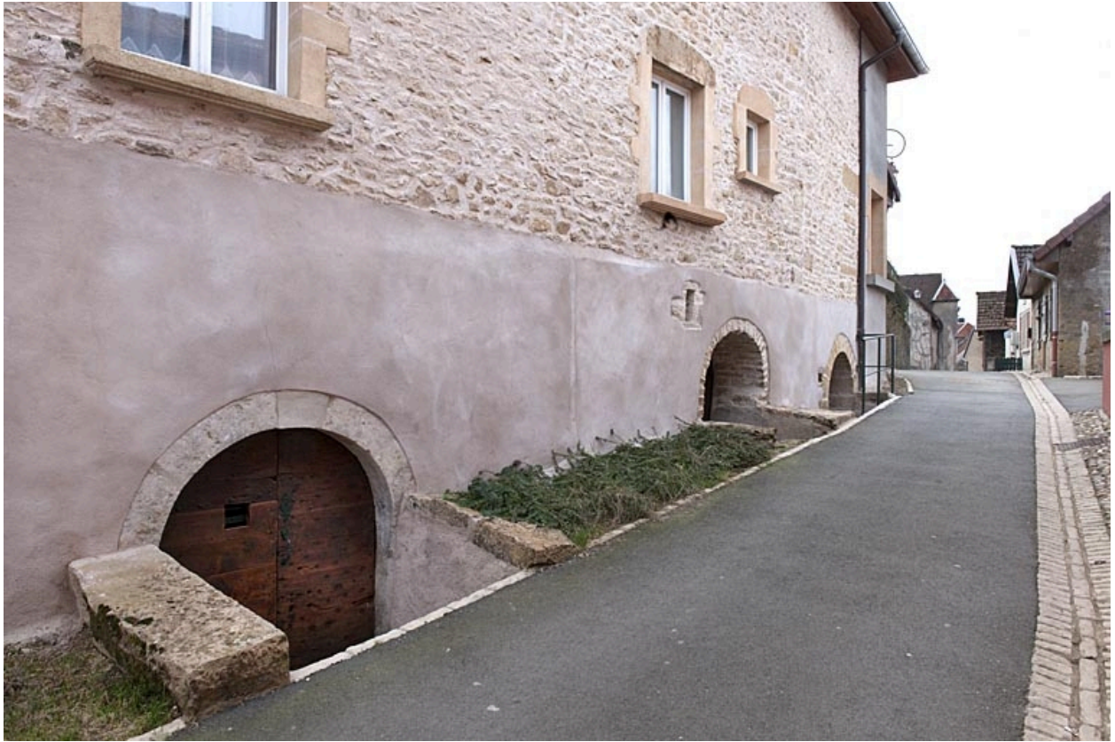
Entrées de cave de la maison à l'angle des rues de la Traverse et de l'Eglise (2010 AL 120).
