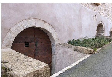
Entrée de cave de la maison à l'angle des rues de la Traverse et de l'Eglise (2010 AL 120). Phot. Jérôme Mongreville IVR43_20112500339NUC4A
