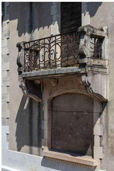
Fenêtre du rez-de-chaussée et balcon du premier étage. Phot. Jérôme Mongreville IVR43_20207000566NUC4A
