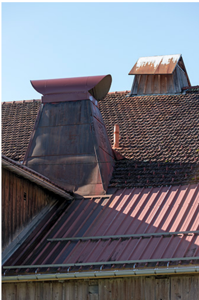
Pan de toiture nord, avec deux "tués".
