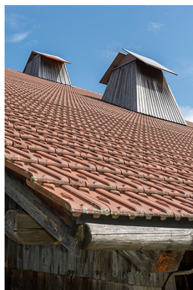
Pan de toiture sud, avec deux "tués". Phot. Sonia Dourlot IVR43_20172501193NUC4A
