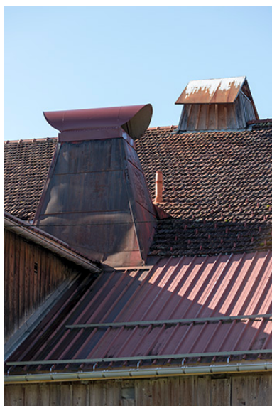
Pan de toiture nord, avec deux "tués".
