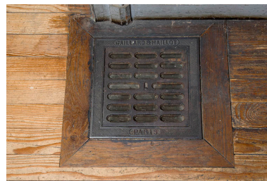
Grille de ventilation du chauffage central. Phot. Sonia Dourlot IVR43_20157000701NUC2A
