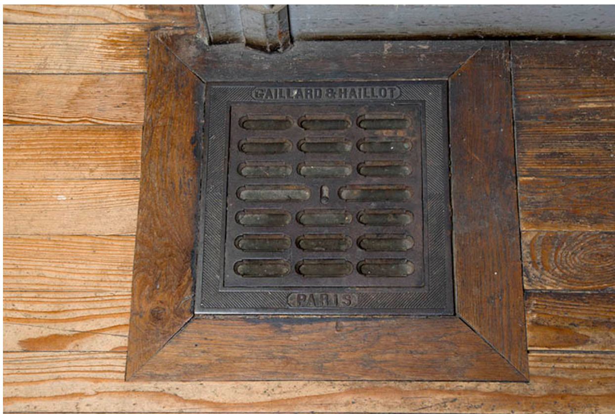
Grille de ventilation du chauffage central.
