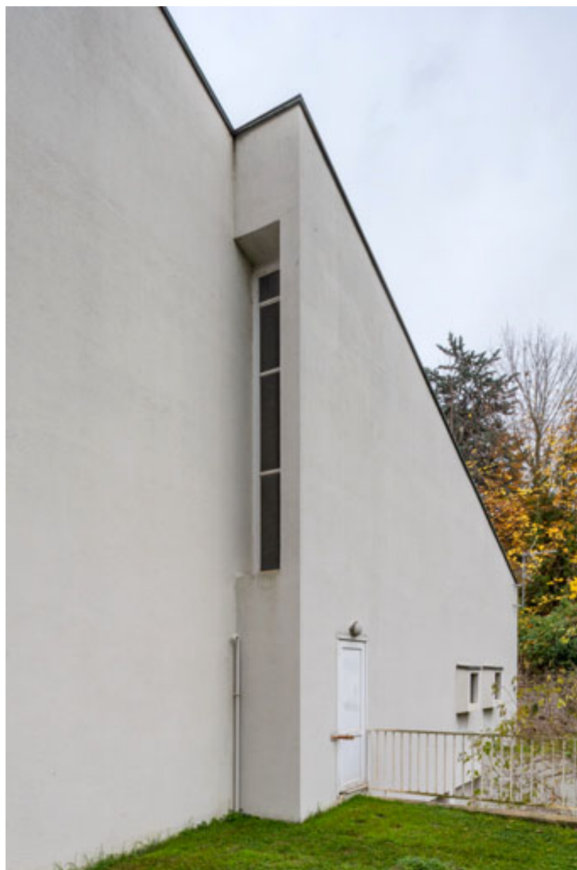
Vue de la baie verticale sur la saillie du mur ouest (baie 2).
