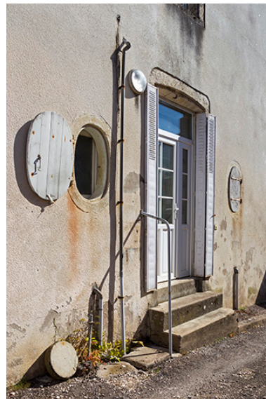
Façade latérale gauche : porte encadrée par deux oculi. Phot. Sonia Dourlot IVR43_20157000398NUC2A
