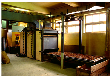
Vue d'ensemble. De gauche à droite : chaudière, séchoir et grille chargée de cônes sur le portique. Phot. Jérôme Mongreville IVR43_19973900706ZA
