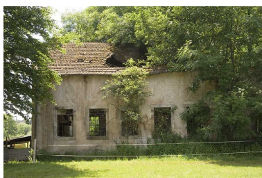
Atelier de fabrication en ruines. Phot. Jérôme Mongreville IVR43_20097000451NUC2A
