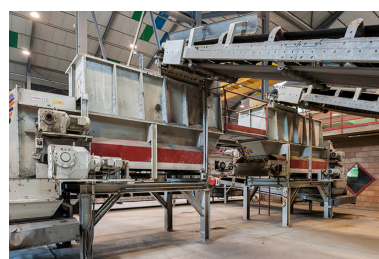
Unité de préparation des terres. Doseurs-tampon.
