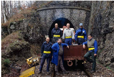
Equipe d'entretien de la voie, à l'extrémité du tunnel de Tancua côté Andelot-en-Montagne. PK 052.913. Phot. Yves Sancey IVR43_20053900598ZA
